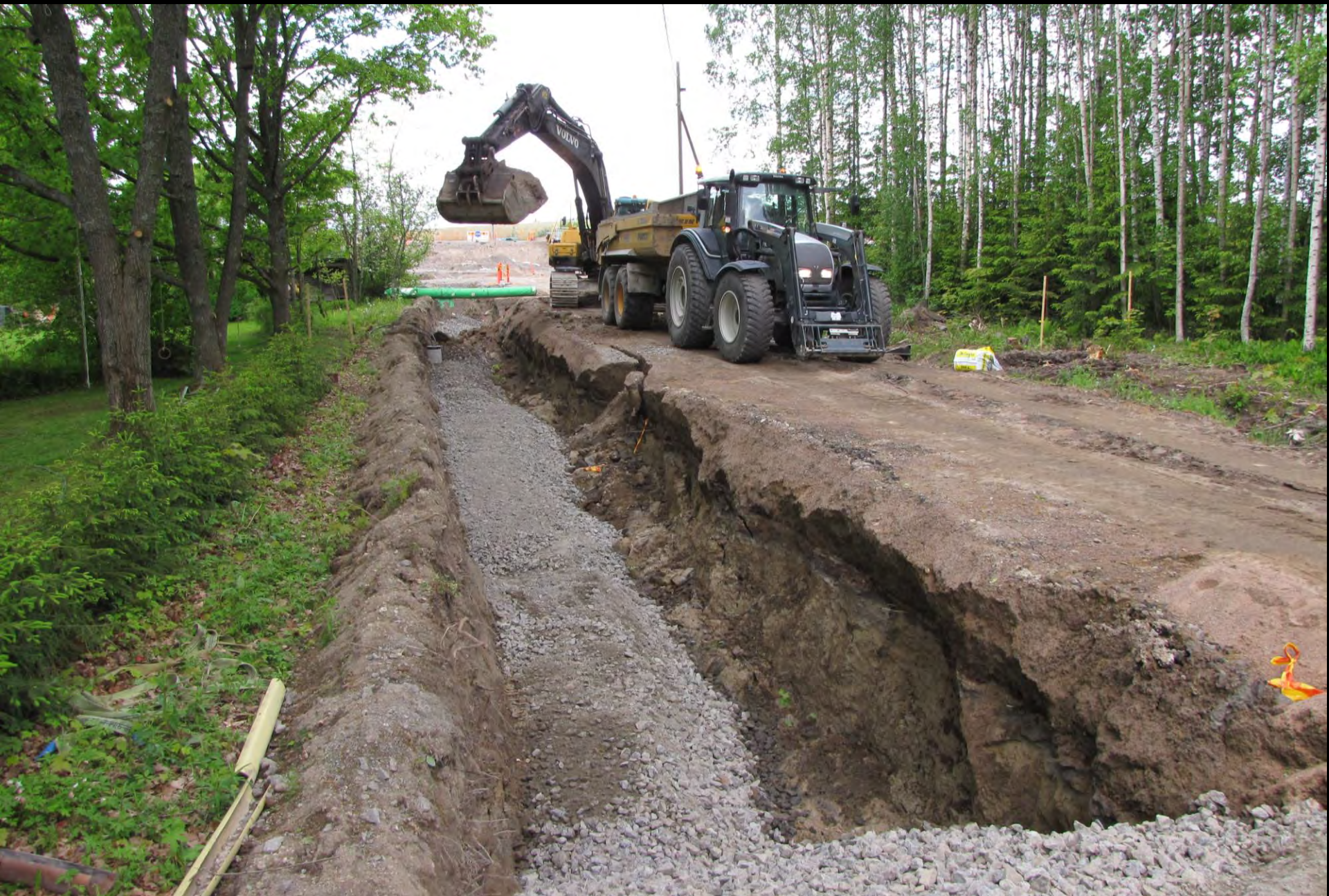
Suojaopasteet puuttuvat, katutyö Puhjontie
