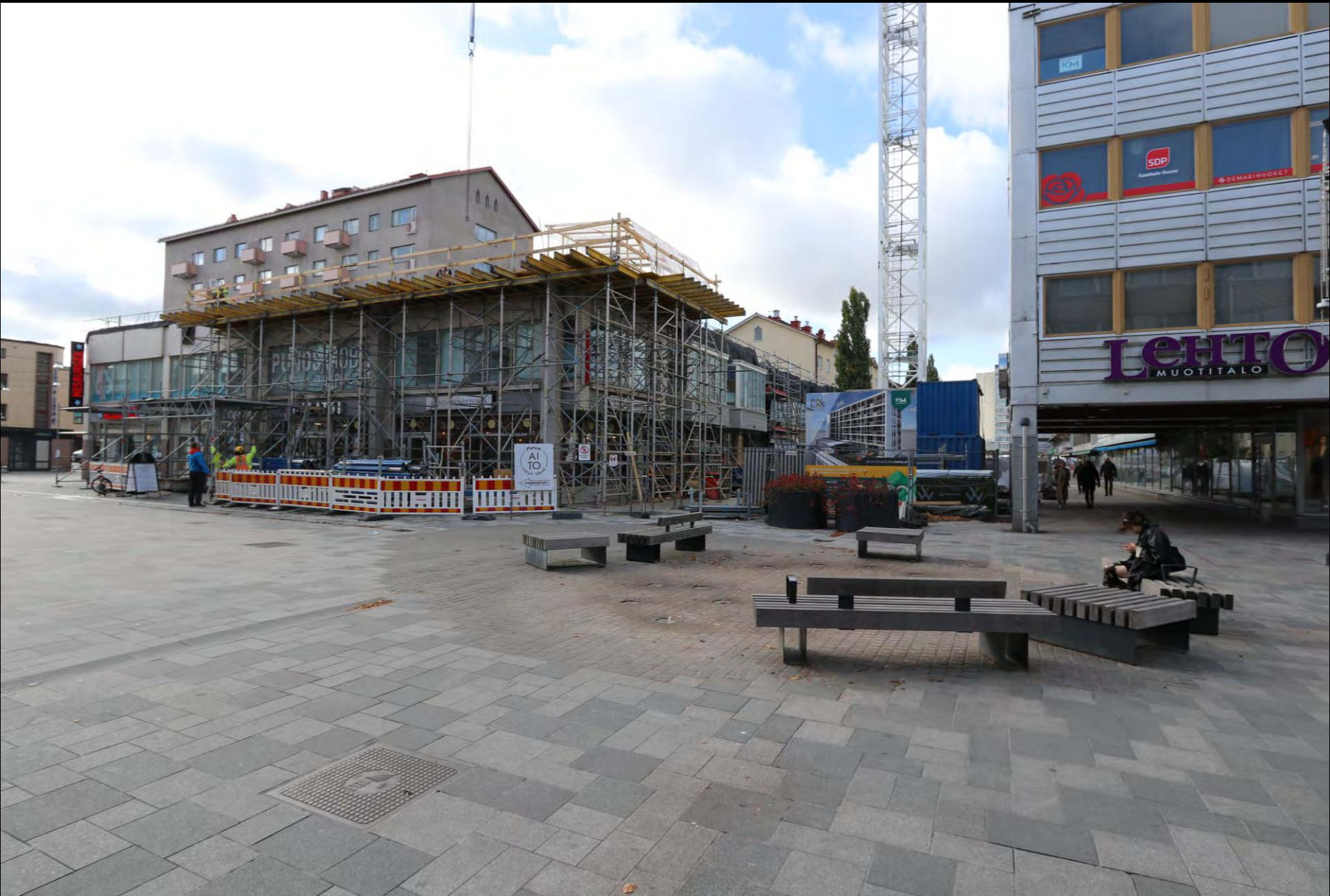
Suojaopasteet puuttuvat, rakennustyö Lasipalatsi
