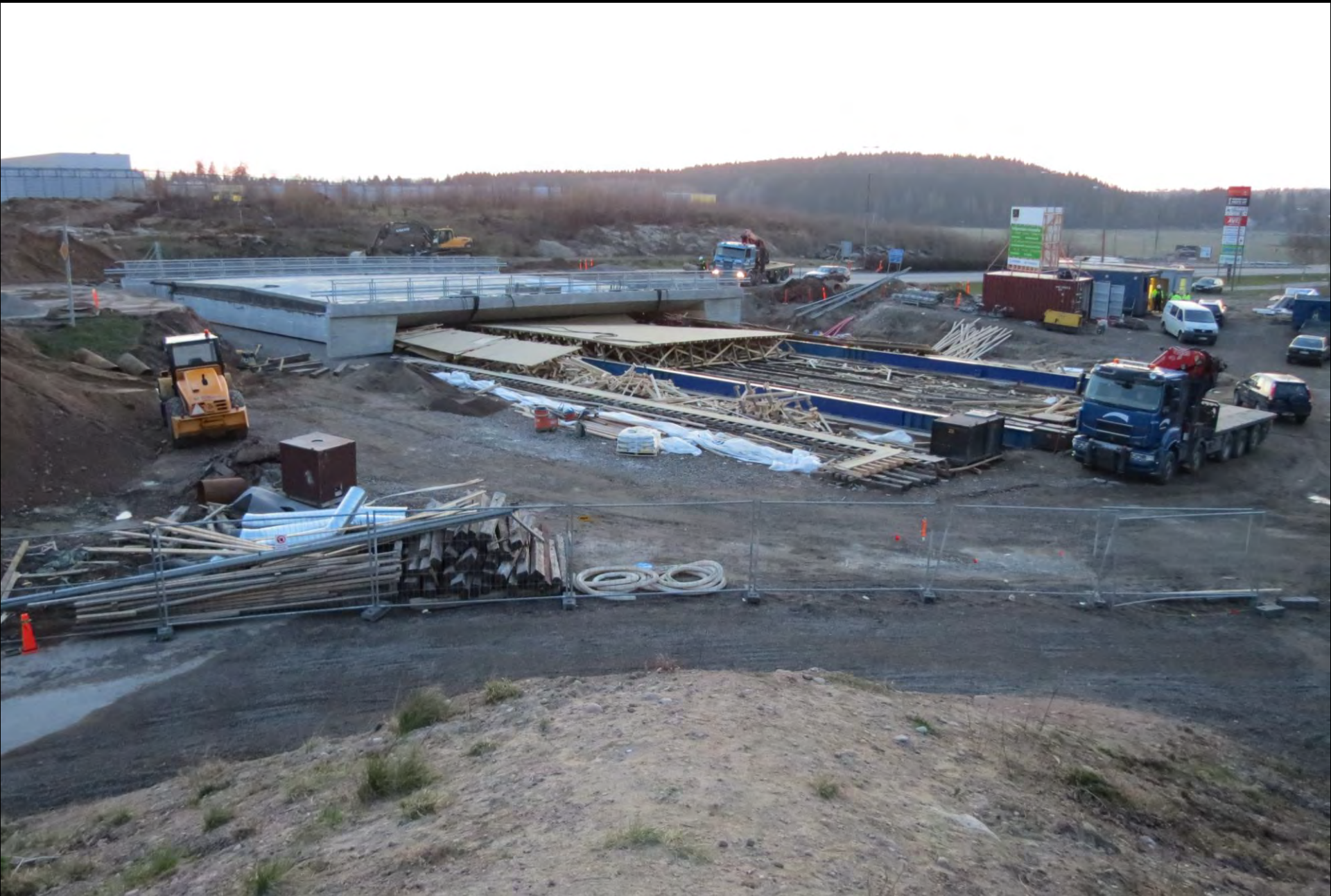
Suojaopasteet puuttuvat, kevyen liikenteen väylän valaistus on puutteellinen katutyö Kuusaantie
