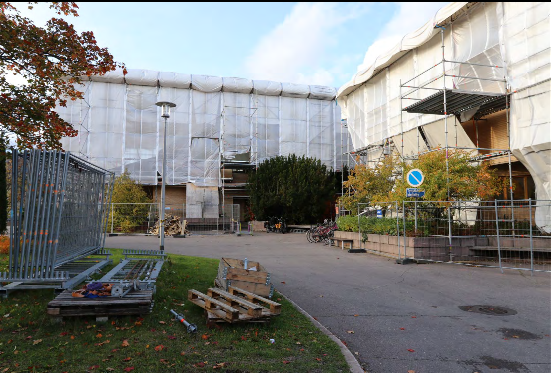
Suojaopasteet puuttuvat, rakennustyö Kouvolatalo
