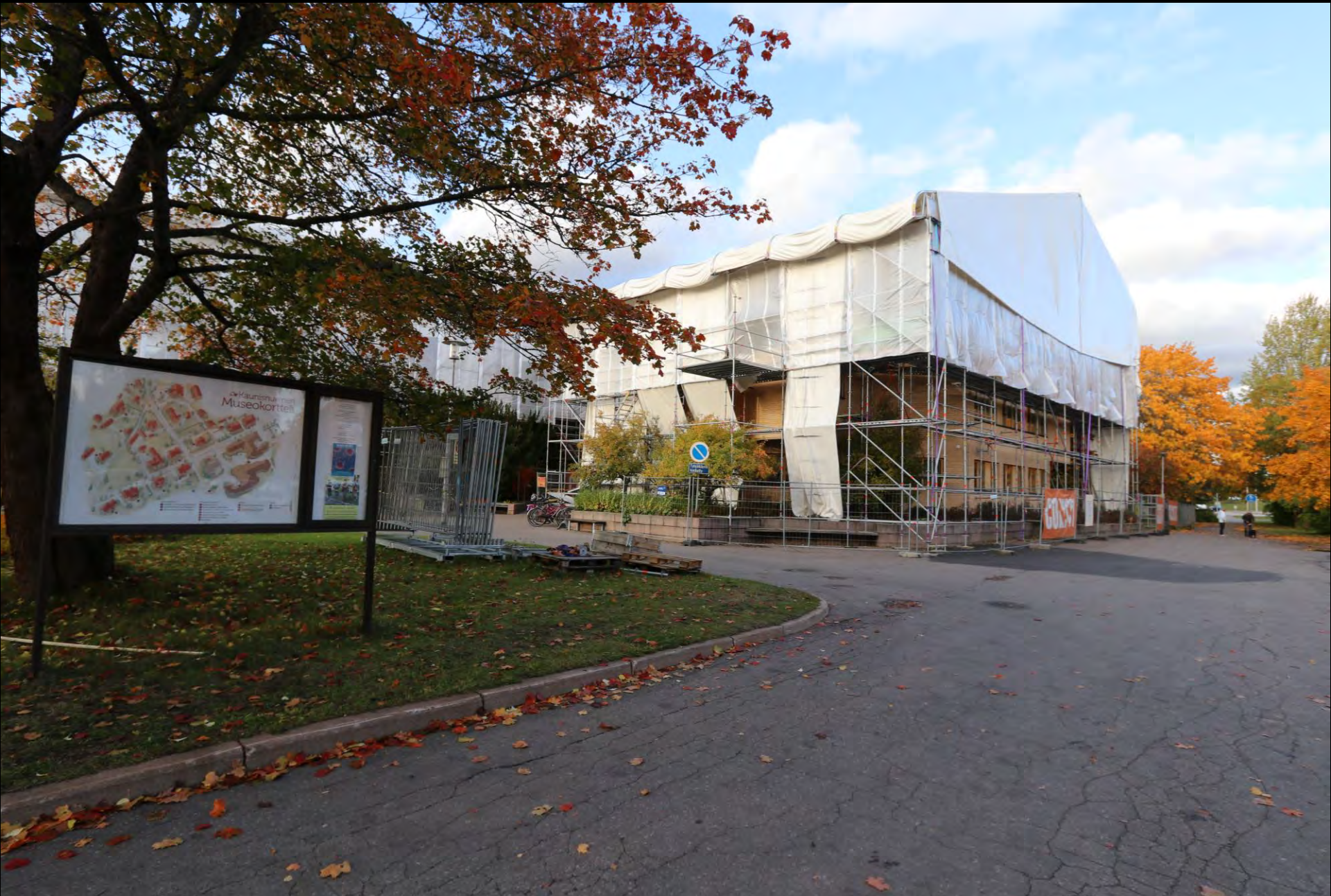
Suojaopasteet puuttuvat, rakennustyö Kouvolatalo
